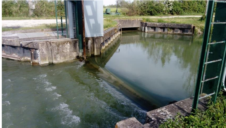
Figure 64 : Vanne de Suze baissée et surverse
