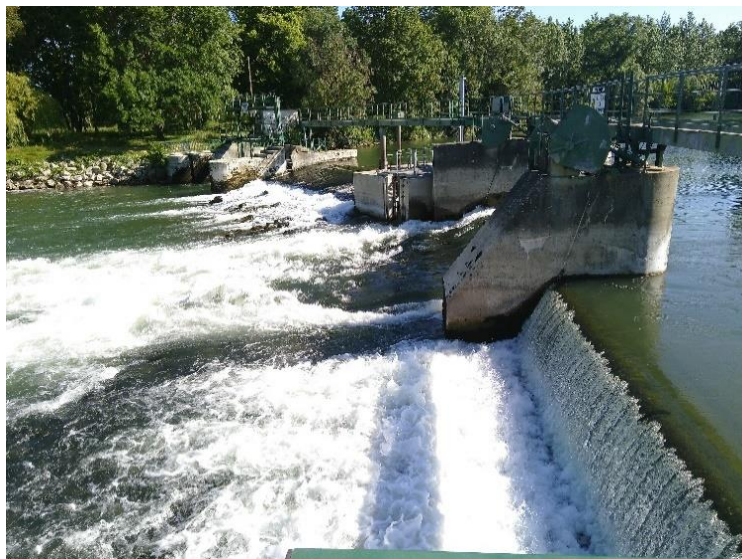
Figure 93 : Crouin le 26/05/20 la passe à poisson est masquée par le bouillonnement de la chute d'eau. Le clapet rive droite est le plus abaissé. Une configuration inverse serait correcte, le clapet rive droite largement relevé permettrait au flux hydraulique sortant de la passe à poissons d'être aisément repérable.
