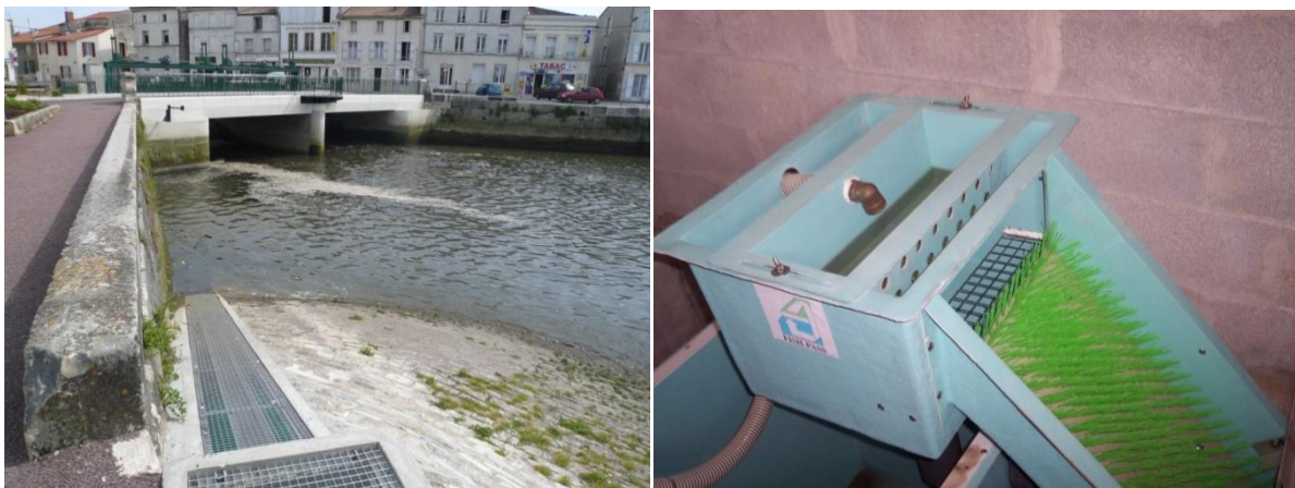
Figure 33: Photos de la passe piège anguilles de Saujon (brosse extérieure sous grille et piège)
